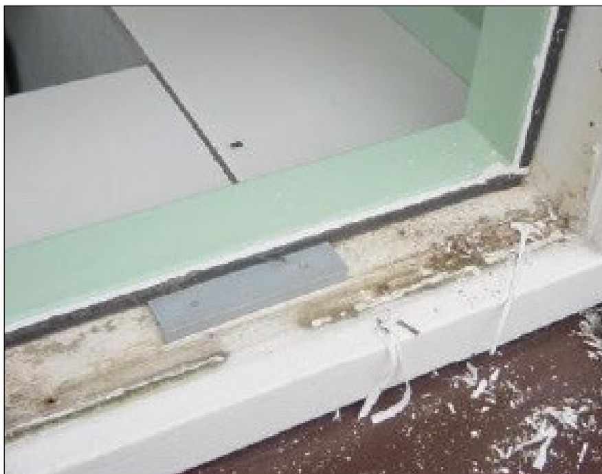
Vervuiling onder de liggende glaslat.
